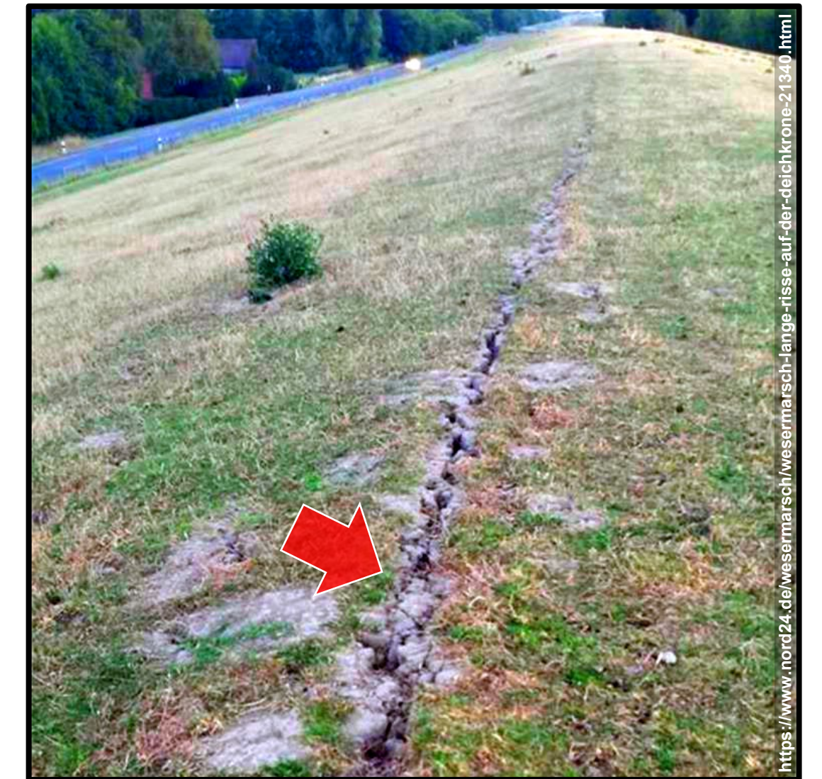
Abb.1: Exemplarische Darstellung eines Risses an einem Deich [Quelle: www.nord24.de, abgerufen am 01.06.2024]
